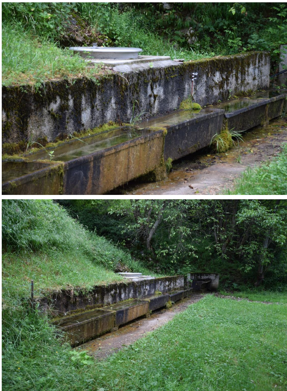
Illustration 12: Vues d'ensemble de l'ouvrage de captage de « La Hount Autrech »
